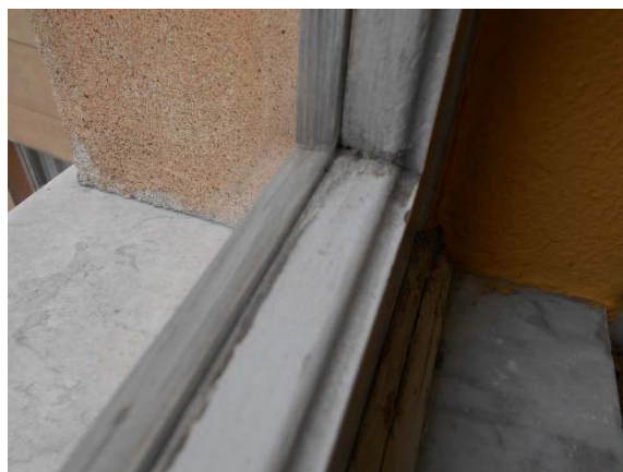
Figura 4.6 - Particolare dei serramenti in legno e vetro singolo – dettaglio angolo vetro
