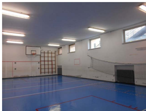
Figura 4.16 - Particolare dei corpi illuminanti ubicati nella palestra
