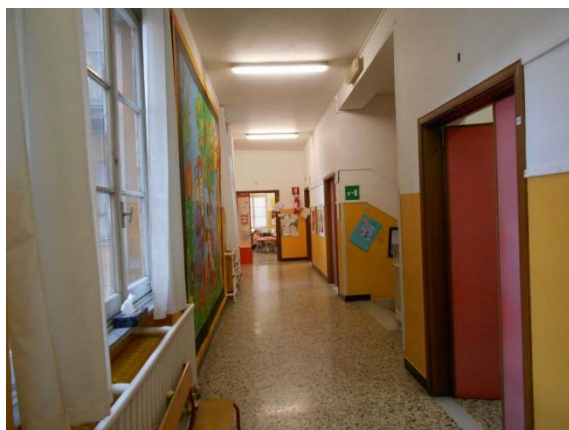
Figura 4.15 - Particolare dei corpi illuminanti ubicati in un corridoio
