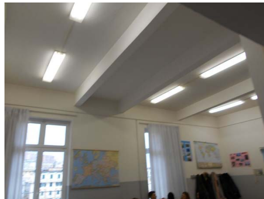
Figura 8.10 - Particolare di una plafoniera a tubi fluorescenti
