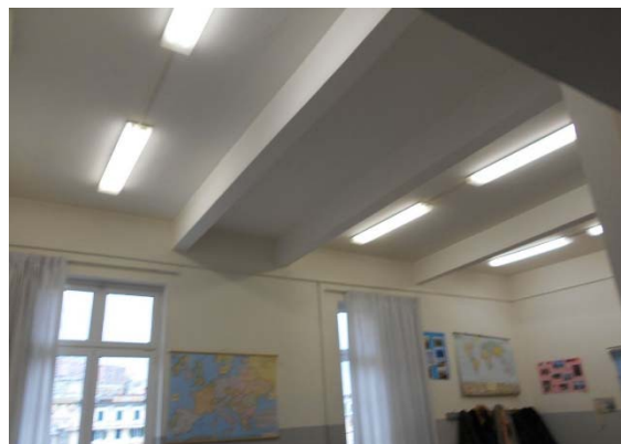
Figura 4.14 - Particolare dei corpi illuminanti ubicati nelle aule scolastiche
